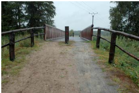
Foto 3: Holzbrücke für Erholungsnutzung und für Straßenverkehr nicht praktikabel
